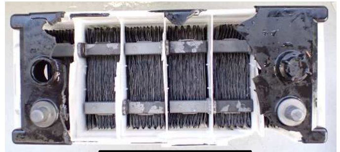
静電気が原因で 破裂したバッテリーの写真
